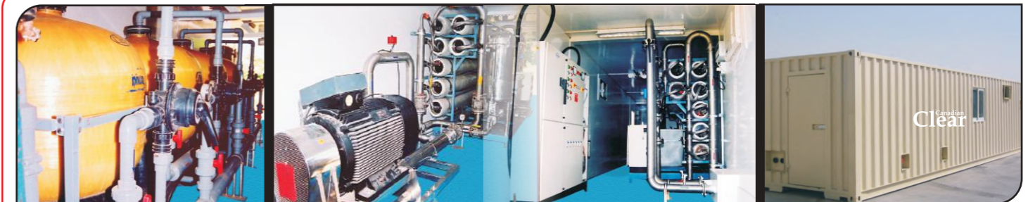
DESALINIZACIÓN – SISTEMAS DE PRE-FILTRACIÓN
